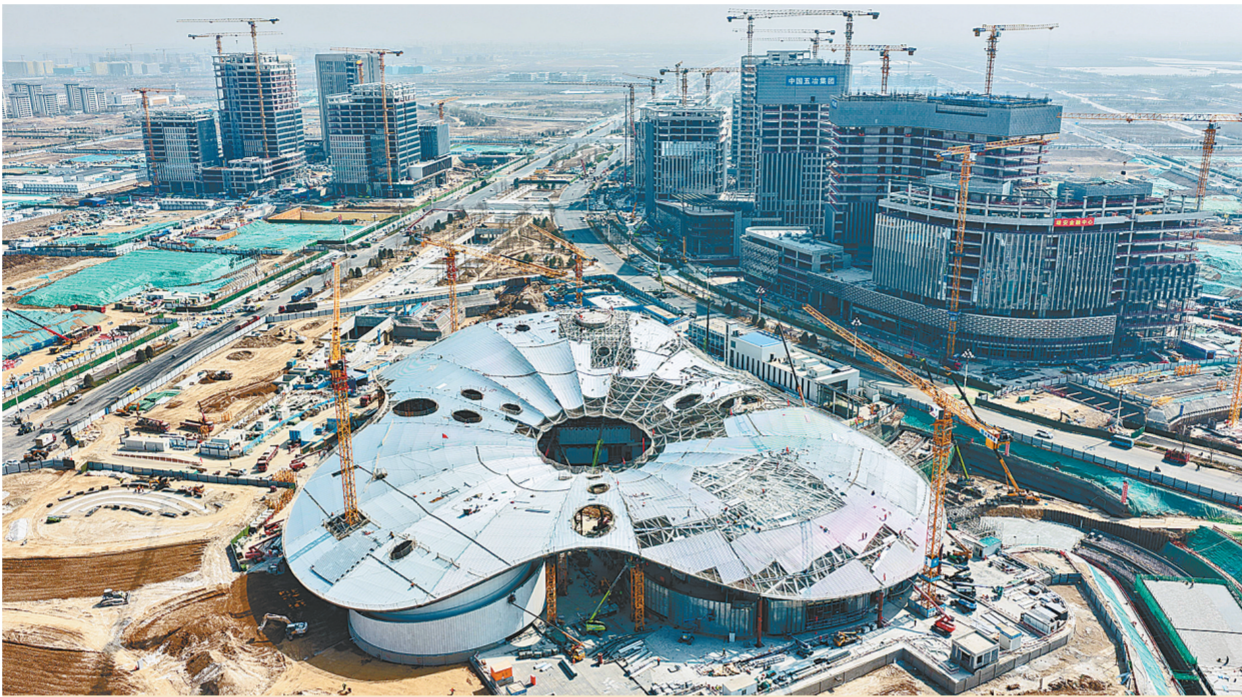
雄安新区启动区城市文化广场项目建设现场(4月2日摄，无人机照片)。 目前，雄安新区启动区城市文化广场项目主体结构已经封顶，正在进行装饰装修、幕墙和机电施工。 雄安新区启动区城市文化广场项目总建筑面积超过8万平方米，涵盖大剧院、音乐厅、美术馆等核心设施。该项目作为雄安新区重要的公共文化地标建筑，集文化展示、休闲娱乐、群众活动于一体，建成后，不仅丰富市民精神文化生活，还将进一步完善启动区城市功能配套，优化城市空间布局，塑造特色城市风貌，成为彰显区域文化底蕴、提升城市品位的核心载体。 新华社记者 牟宇 摄
