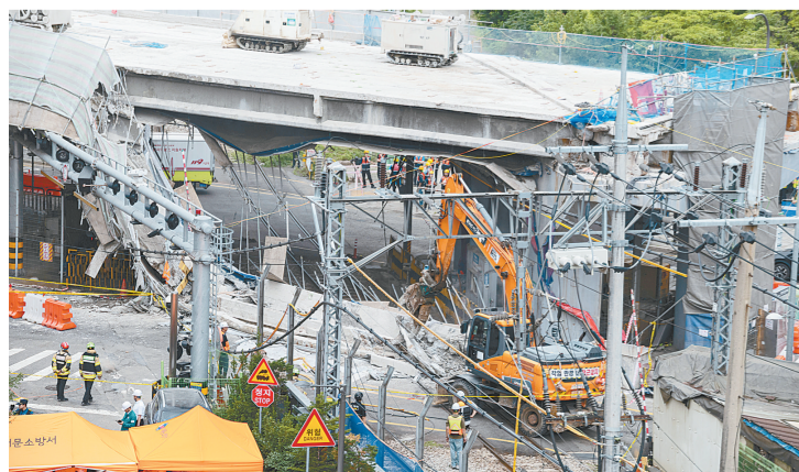
韩国首都首尔一座高架桥的拆除现场26日下午发生坍塌事故,目前已造成3人死亡、至少3人受伤。这是5月26日在韩国首尔拍摄的高架桥坍塌的事故现场。
